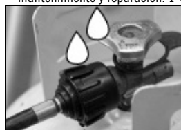
Fuga Regulador y manguera
