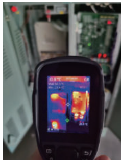
Erkennung der Energieverteilung Schaltschrank
